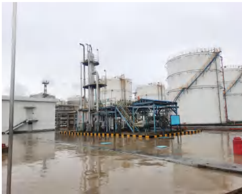
图 2.5-9 中间罐区及污油罐区油气回收设施
