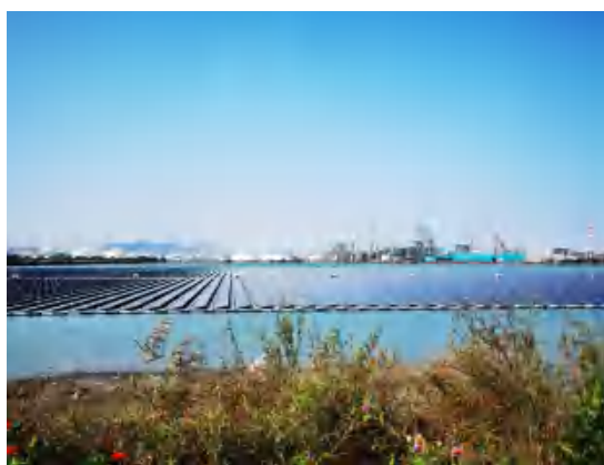
厂址外西侧水面光伏
