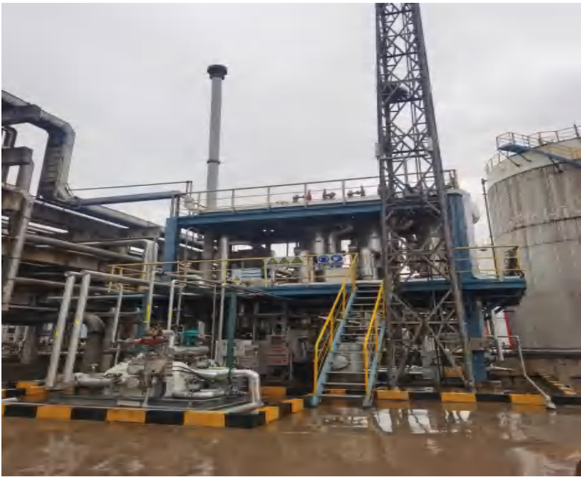
图 2.5-11 苯、二甲苯罐区及油气回收设施
