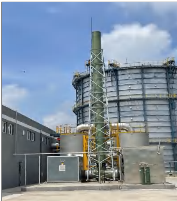
图 2.5-16 危废暂存库 VOCs 治理设施
