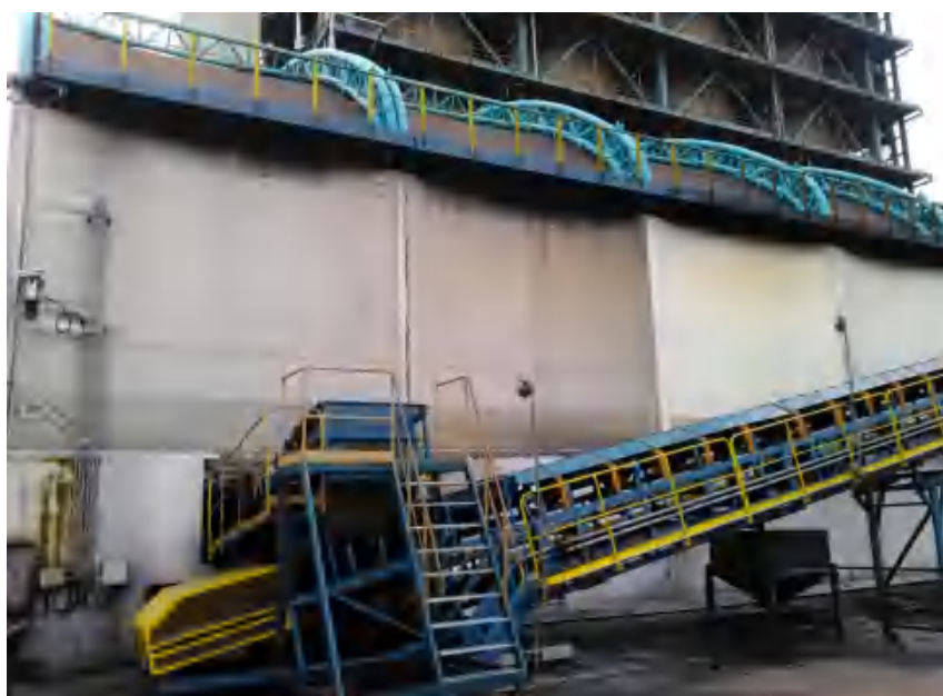
图 2.5-15 延迟焦化装置密闭除焦设施
