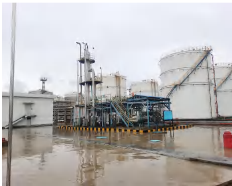
图 2.5-9 中间罐区及污油罐区油气回收设施
