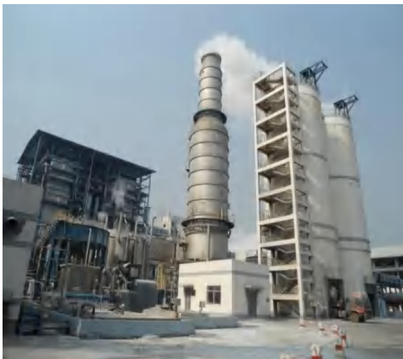
图 2.5-3 CFB 锅炉烟气排放烟囱
