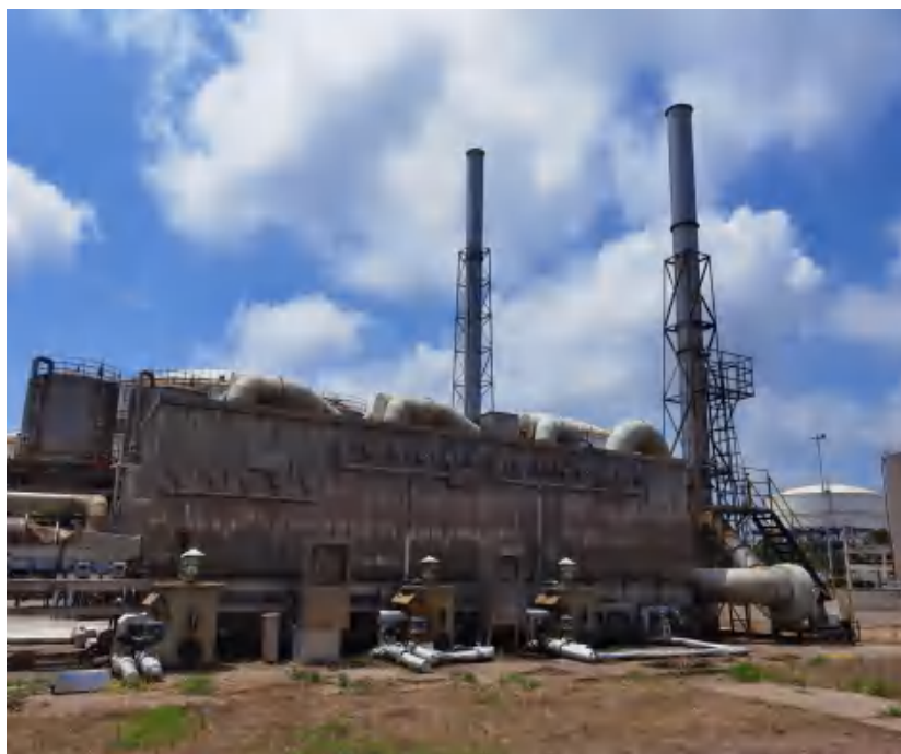
图 2.5-6 污水厂废气处理设施
