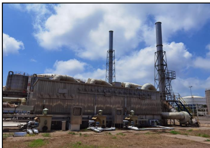
图 4-1 污水厂废气处理设施
